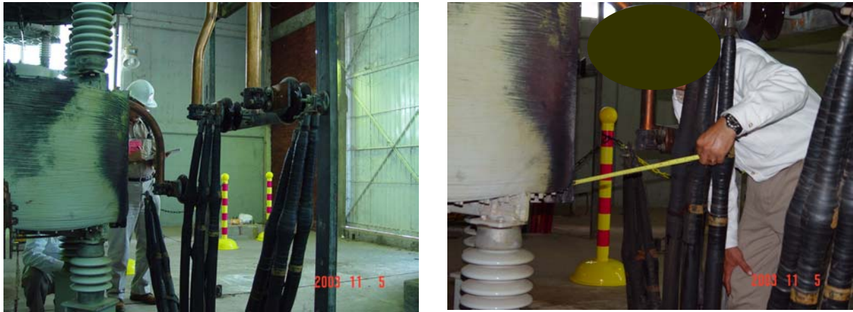
Fig. 4.15 Fotos del reactor que presentó una falla a tierra por sobretensión.
