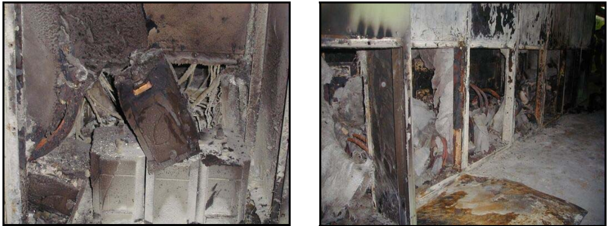
Fig. 2.14 Daños en el tablero del Bus “A” donde se encontraba alojado el TP en conexión delta abierta.
